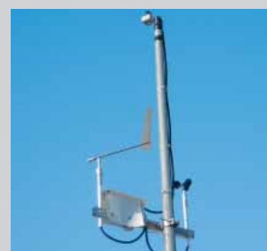
gestion à distance de l'éclairage public du bord de mer (ville de Cagnes-sur-Mer)
