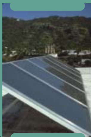
Installation solaire thermique
