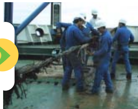
Mission de maintenance de câbles à bord du "Raymond Croze"
