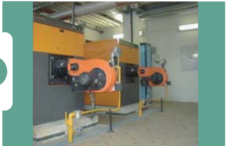
Installation réglementée de réfrigération (Champagne-Ardenne)
