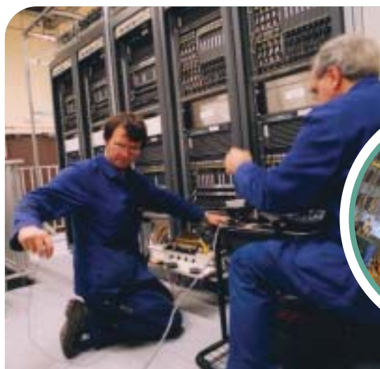
Câblage de têtes de réseaux au central de Lille
