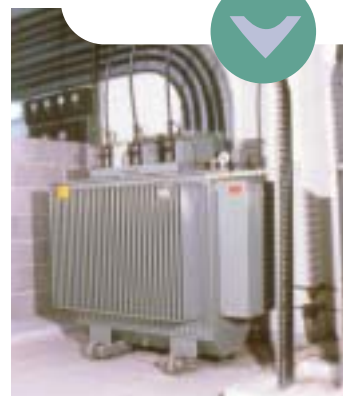
Transformateur fonctionnant au PCB-PCT
