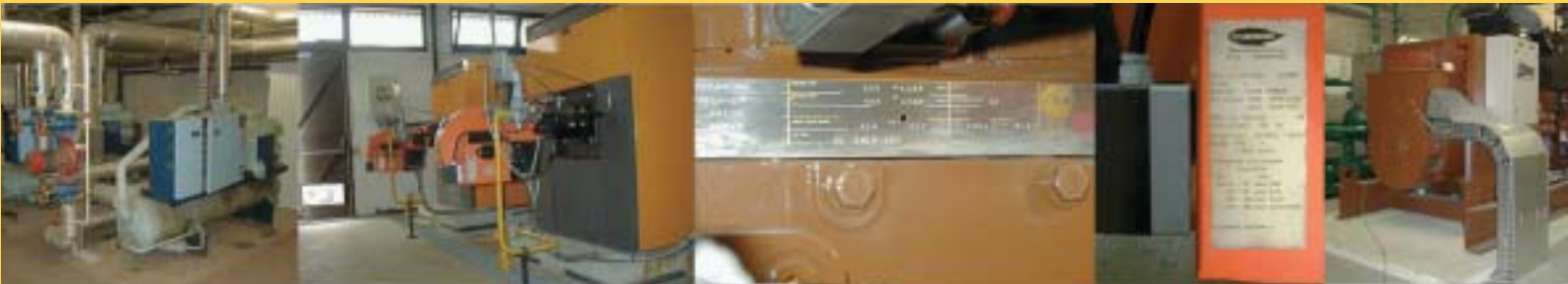
Installations de réfrigération ou de compression
