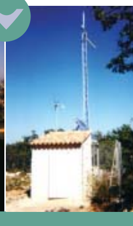
Installation couplée solaire et éolienne (site de Chastillon - Var)
