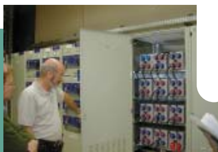
Inspection d'une installation d'énergie (Champagne-Ardenne)
